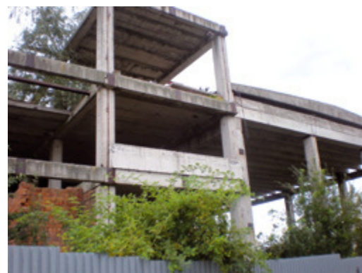
Obrázok 15 Budova schátraného objektu na Starozagorskej ulici
